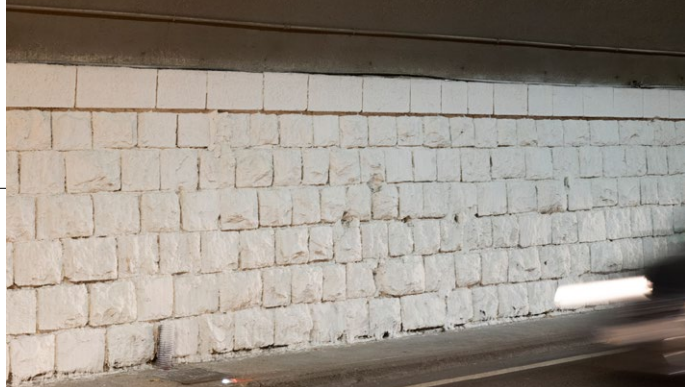
3. Il colore bianco dei piedritti conferisce luminosità alla galleria a tutto vantaggio della sicurezza dell'utenza in transito
