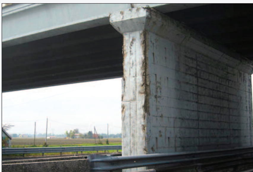
2. Un esempio di struttura stradale soggetta a carbonatazione
